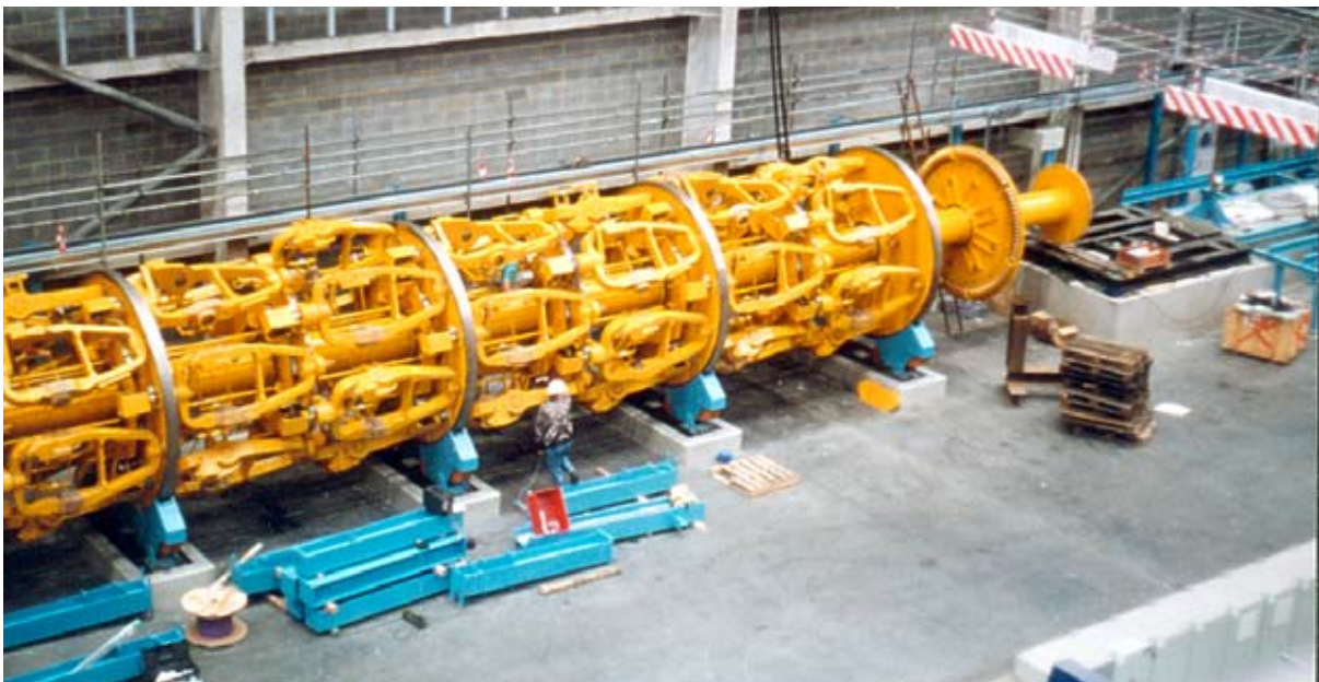
Drahtkorb Nr. 2 während der Anlagen-Aufbauphase
